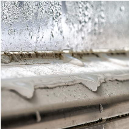
Humedad por condensación
