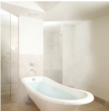
Humedad por condensación. Vapor
