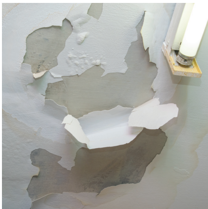
Humedad por filtración/gotera
