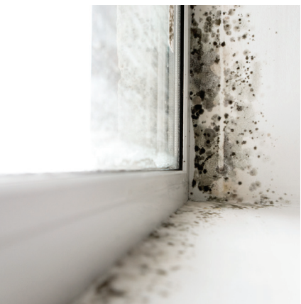
Humedad por condensación. Moho
