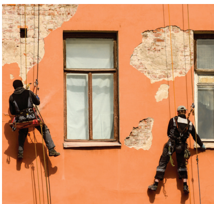
Humedad por filtración/fachada
